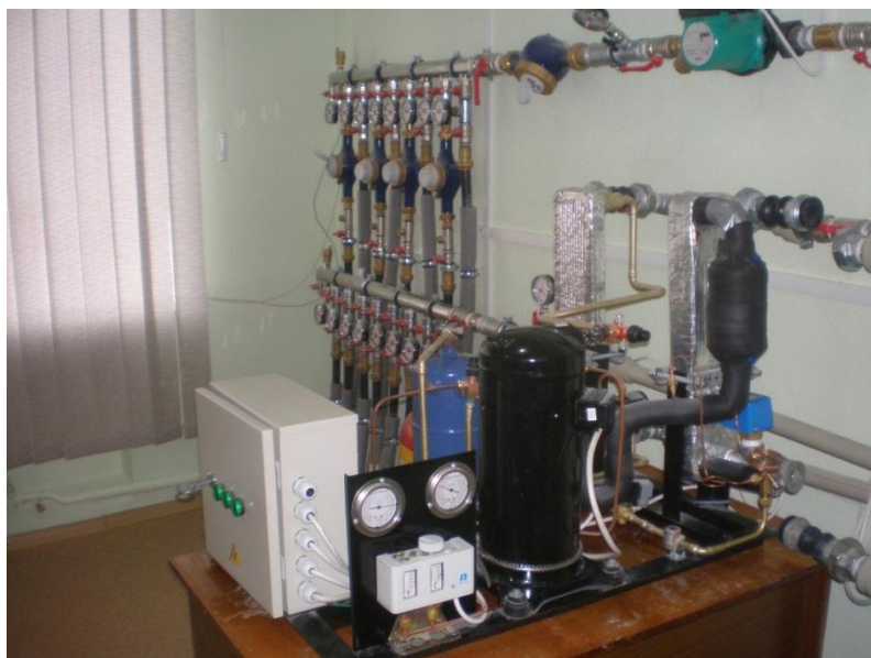
Рис. 1. Наземная часть геотермальной экспериментальной системы УкрГГРИ
